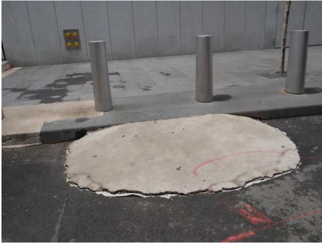
Ryc. 14.2. Na obejściach należy umożliwić zjazd z chodnika poprzez wykonanie tymczasowych pochylni (autor: M. Wysocki)
